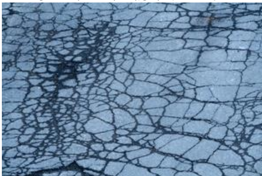
شکل شماره ۱: ترک‌خوردگی پوست سوسماری در روسازی آسفالتی
