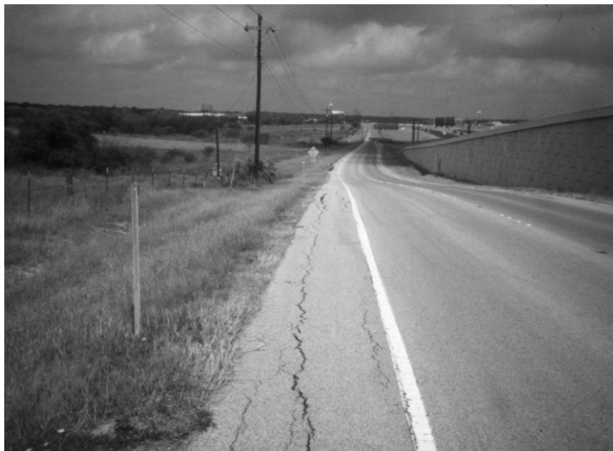
شکل شماره ۵: ترک خوردگی لبه در روسازی آسفالتی
