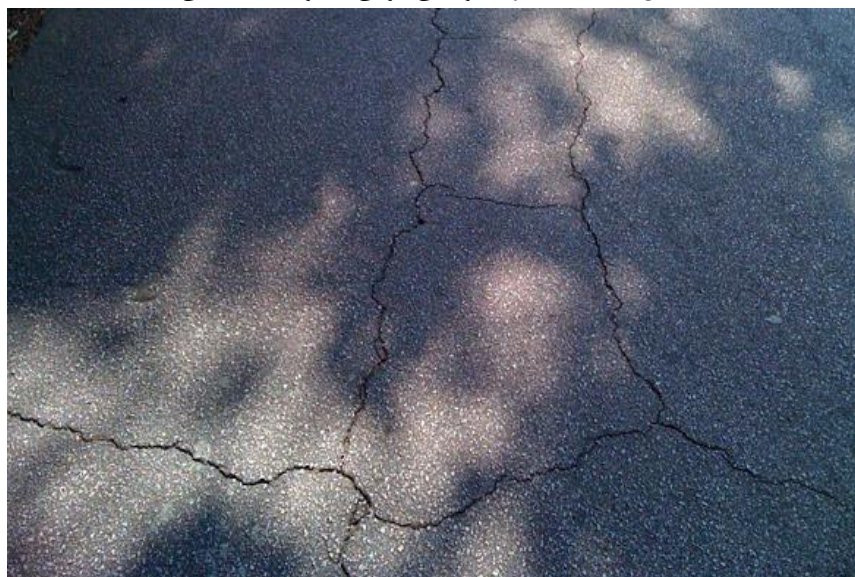
شکل شماره ۲: ترک خوردگی بلوکی در روسازی آسفالتی
